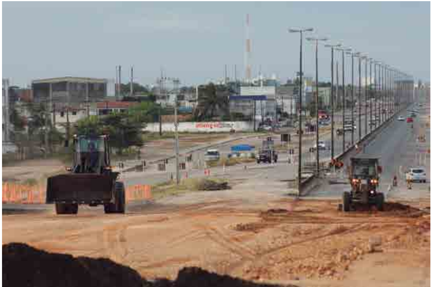
Obra está sendo executada pelo 1º Grupamento de Engenharia de Construção e visa a adequação de capacidade e segurança no trecho da rodovia
