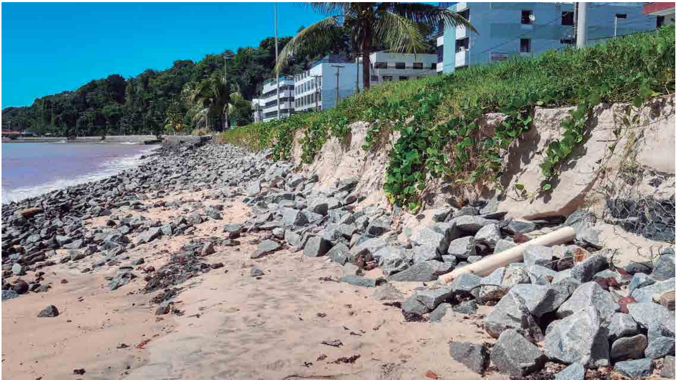
Faixa de areia de trecho do Cabo Branco está intransitável devido às pedras que, segundo moradores, pertencem à obra da falésia; Prefeitura afirma que parte é formada por sedimentos naturais e de material que se desprende do gabião de proteção da calçadinha
